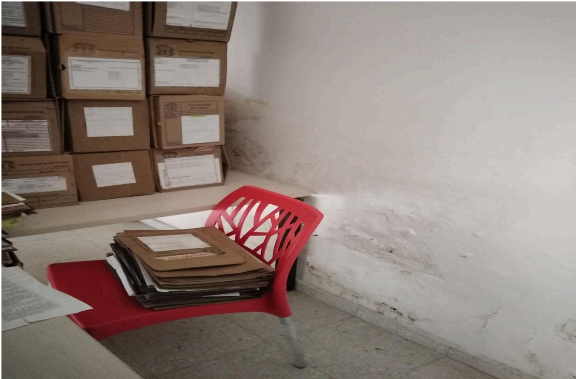
Figura No. 7. Se observa humedad en las paredes.
